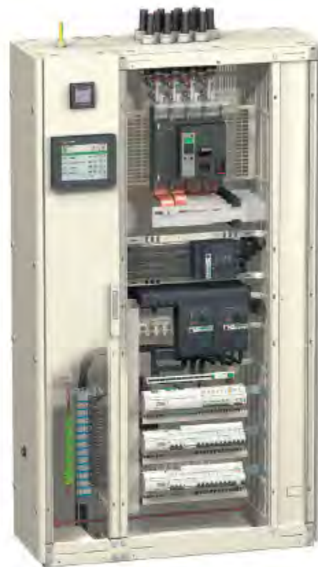
Cuadro de Baja Tensión Inteligente
