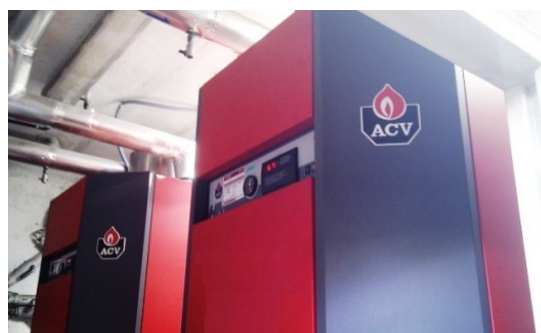
SISTEMA SEMI-INSTANTÁNEO INSTALADO 2 ACV HEAT MASTER 201
